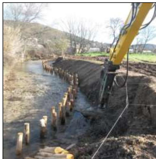
Figure 2 : Réalisation de travaux d'aménagement de berges de l'Huveaune à Auriol par le SIBVH
